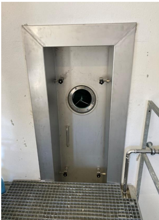
Porte étanche au réservoir du Tavalet
